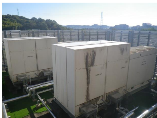
看護学科棟空調機現状
