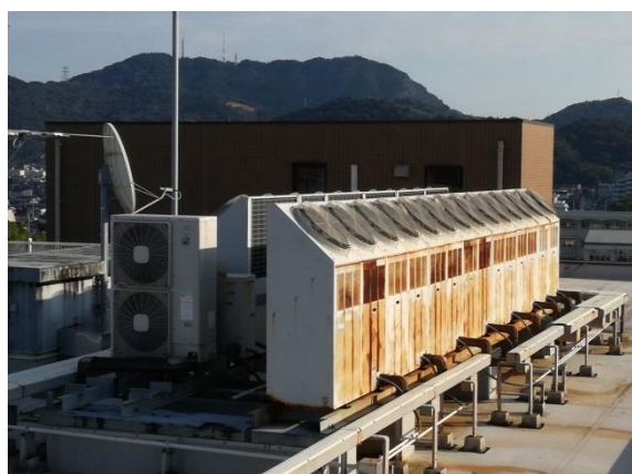
情報科学棟空調室外機現状
