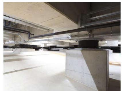
第二病棟地下免震装置
