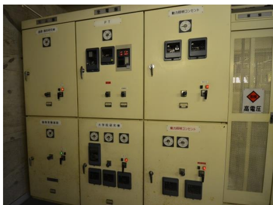
大学院研究棟圧受変電設備現状
