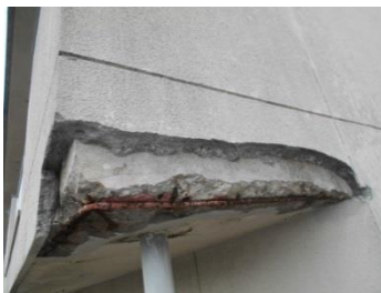
鉄筋の爆裂による コンクリート剥落
