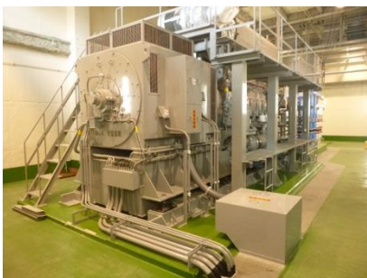
自家発電設備(6.6kV2,500kVA)
