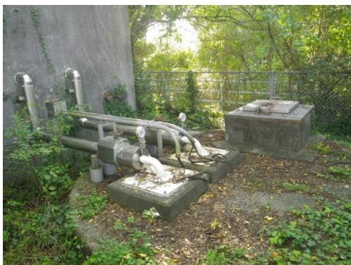
給水用井戸現状
