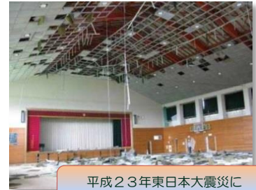
平成23年東日本大震災による屋内運動場等の被害
