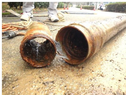
消火管現状(学部側)
