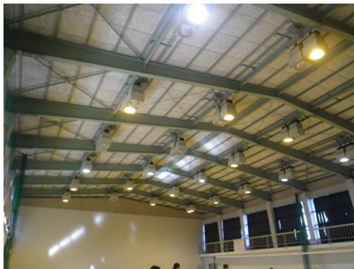
体育館照明設備現状
