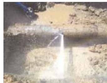
経年劣化による 給水管本管からの漏水
