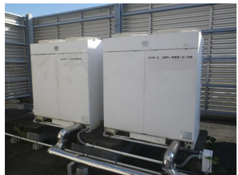
遺伝子実験施設空調室外機現状
