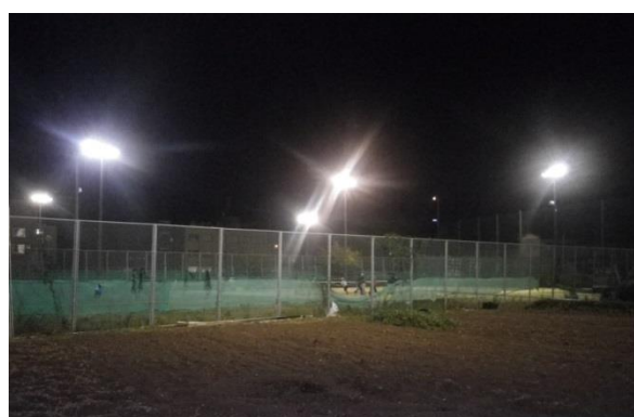
テニスコート照明設備現状
