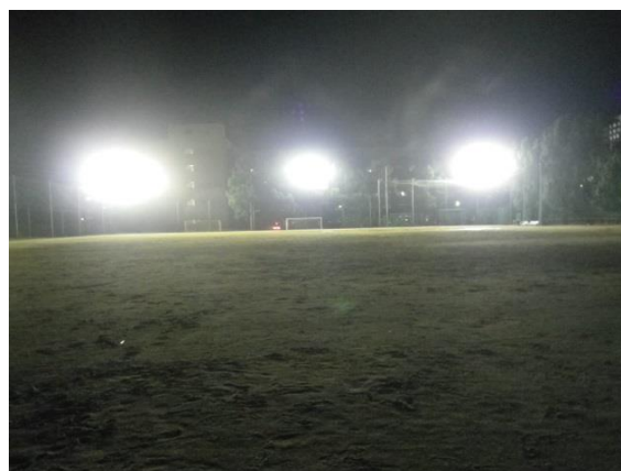
運動場照明設備現状
