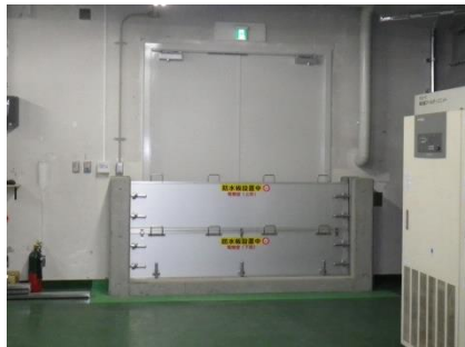
電気室止水扉
