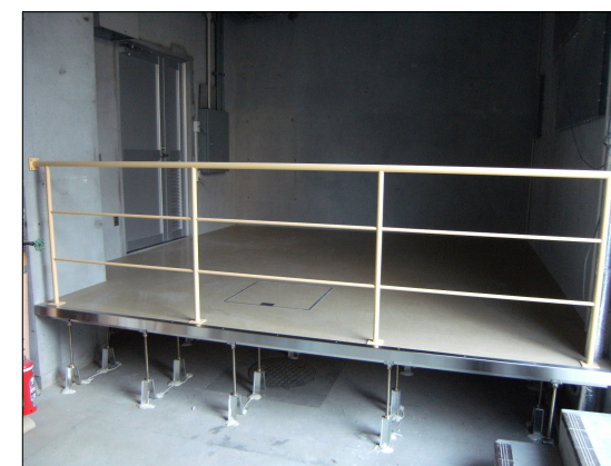
機械室（改修後）
