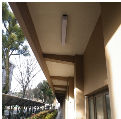
1階オープン廊下照明器具（同上）
