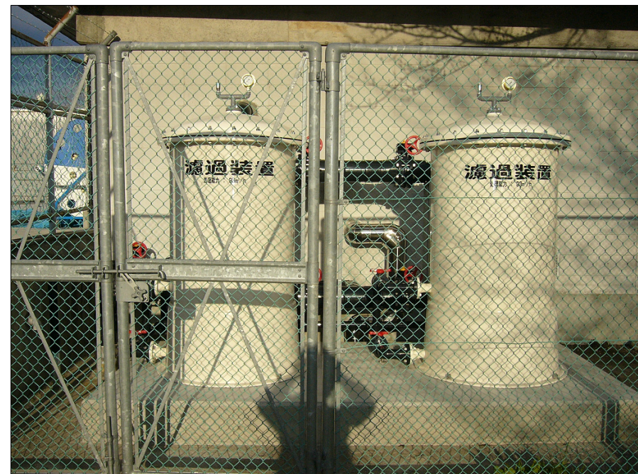
プール濾過装置（改修後）
