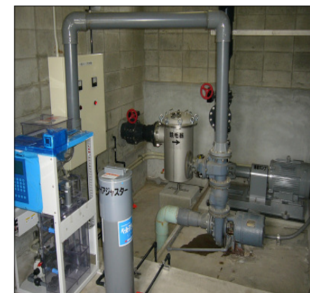
濾過機付帯設備（改修後）
