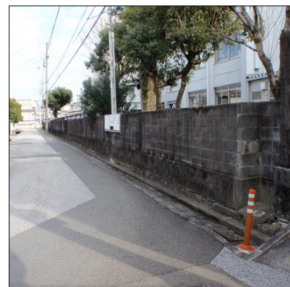
コンクリートブロック塀（改修前）
