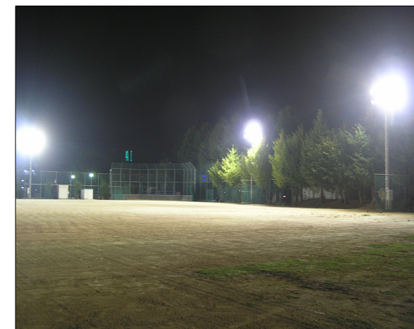
夜間点灯状況
