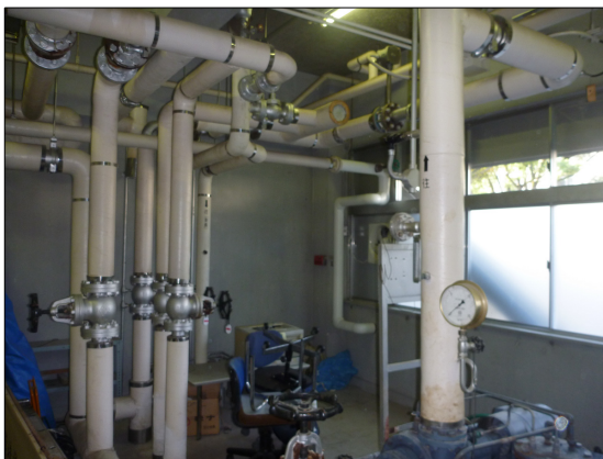
人文学部棟機械室（改修前）
