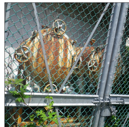
プール濾過装置（改修前）
