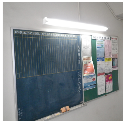
掲示板用照明器具
