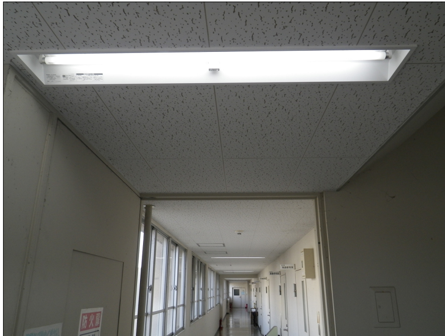
各階廊下照明器具（人感・明るさセンサー付）
